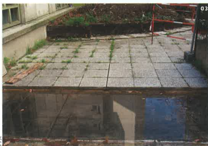
01 La rénovation de l'étanchéité de l'esplanade du centre commercial Jeanne Hachette intègre une protection en dalles sur plots en céramique.
